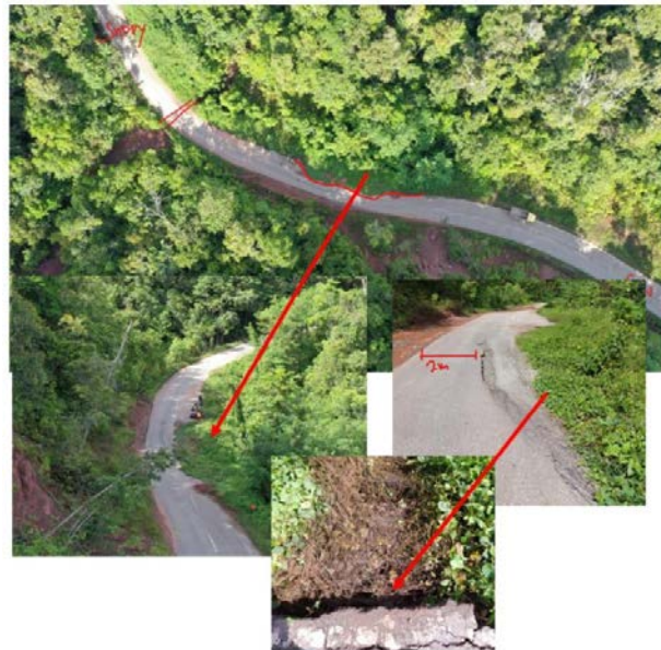
Gambar 4. Kondisi Existing Longsoran
