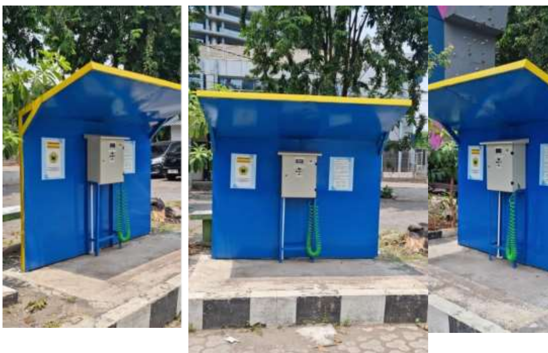
Gambar 6 Rumah Pompa Mandiri Bertenaga Matahari
