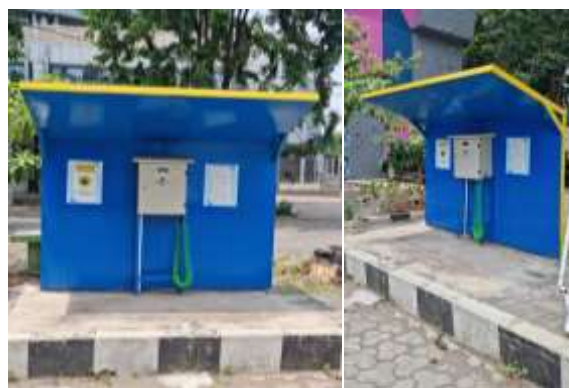
Gambar 10. Wujud rumah pompa angin tenaga surya
